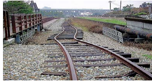
圖 5 因地震造成鋼軌的變形
