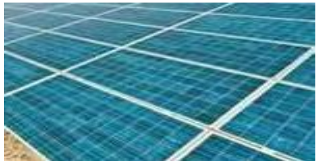
圖 1-5 太陽能發電廠
